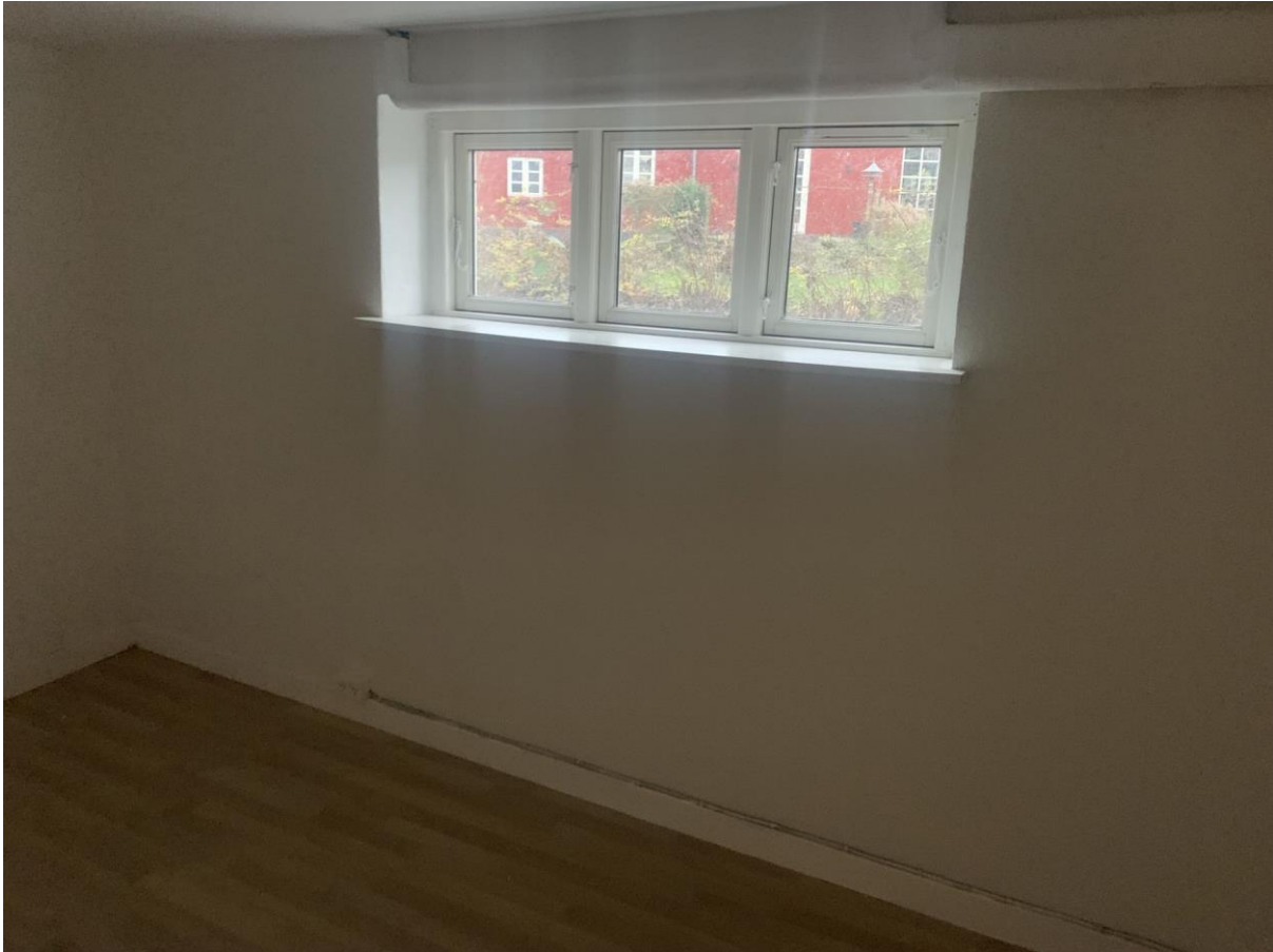
Vinduer i opholdsrum i kælder sidder for højt
