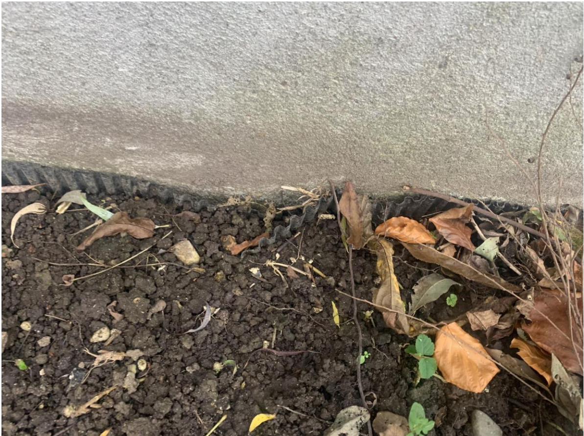
Fugtmembran ikke monteret korrekt
