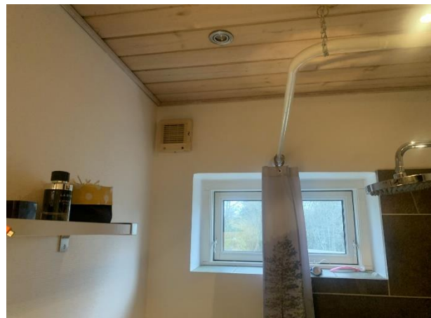
Manglende udsugning i mekanisk ventilation i badeværelse
