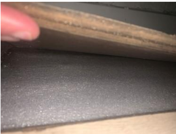
Aftrykssted nr. 4 under gulvbelægning i opholdsrum i kælder
