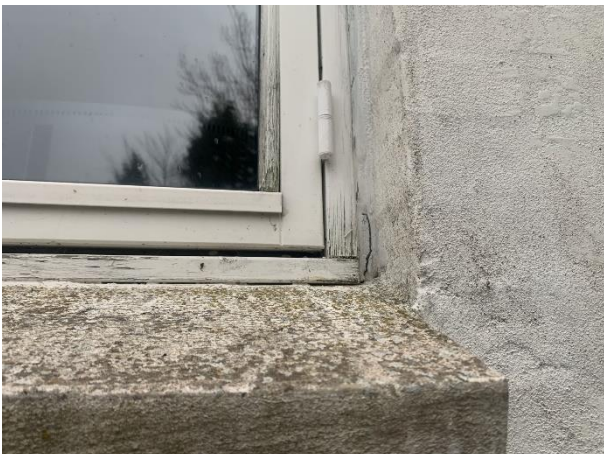
Mindre skader på vinduesfuger
