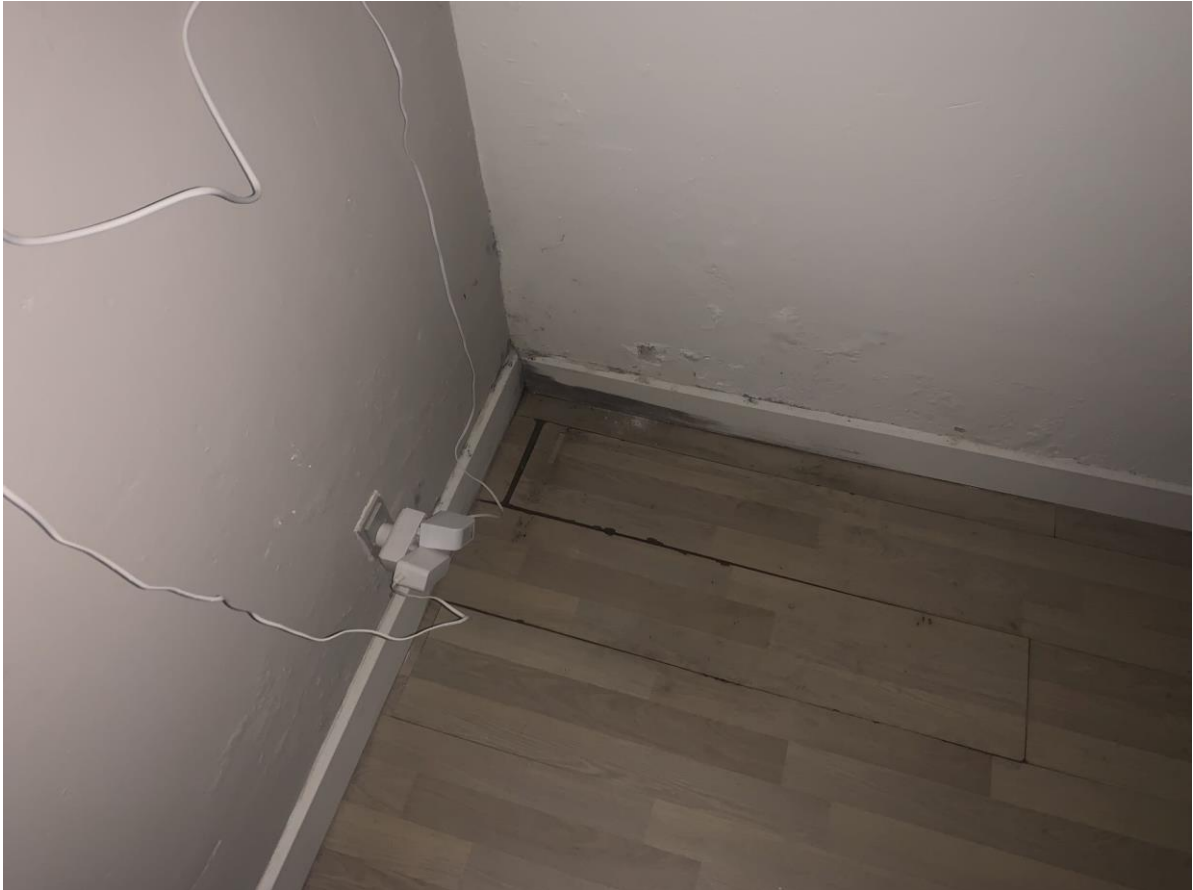
Fugtskadet gulvbelægning i opholdsrum i kælder
