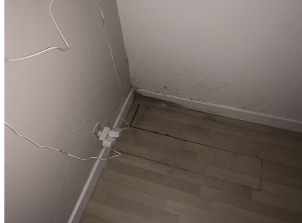
Fugt i gulvbelægning
