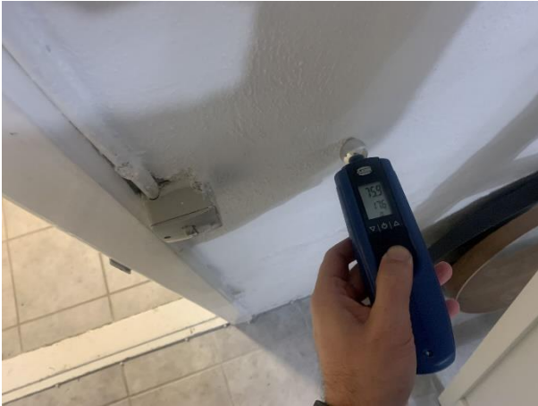
Fugt i skillevægge, kælder
