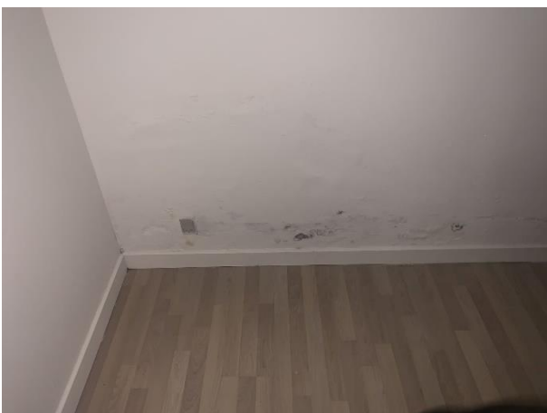
Skimmel på skillevægge i kælder
