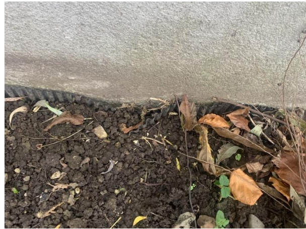
Fugtmembran ikke monteret korrekt
