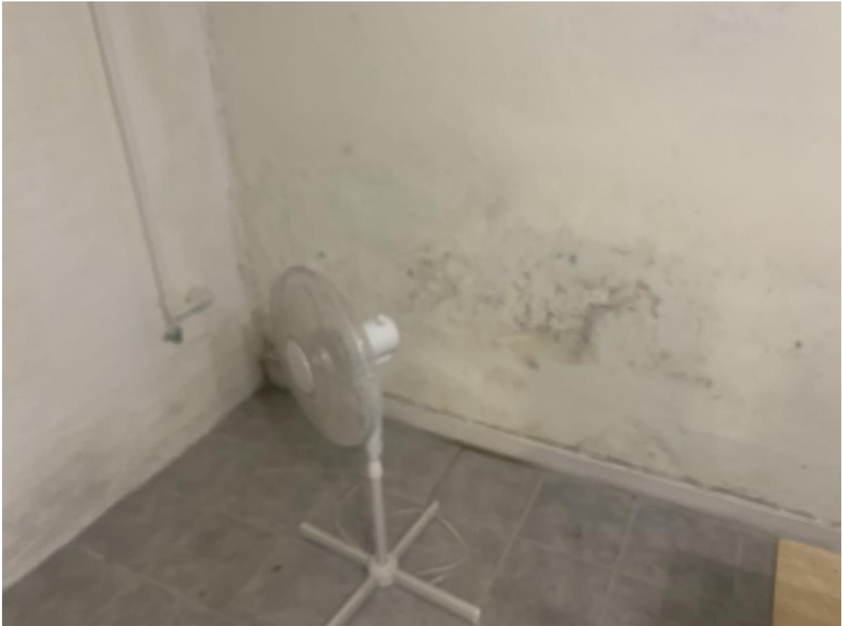
Misfarvninger på ydervæg i kælderrum
