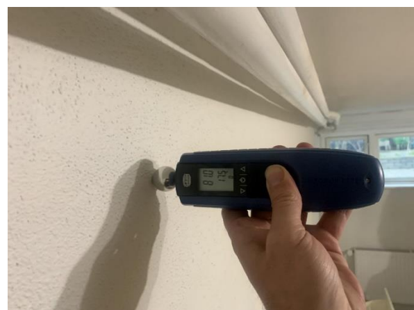
Fugt i kælderydervægge
