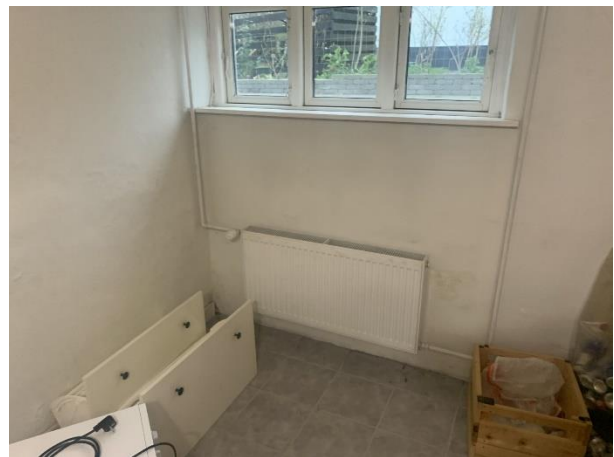
Redningsåbninger i opholdsrum i kælder sidder for højt
