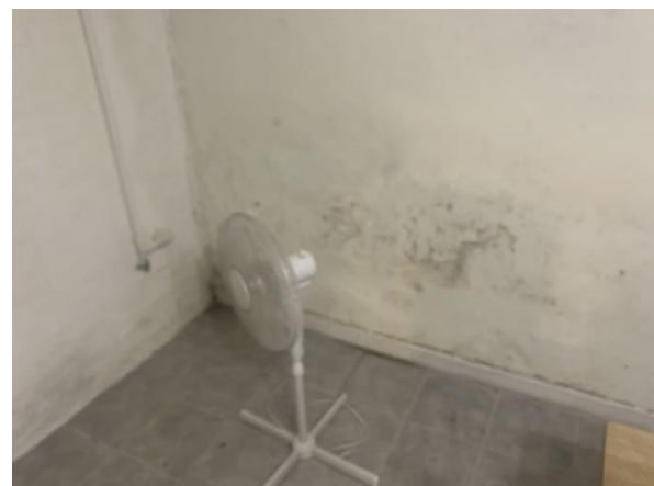
Skimmel på ydervægge i kælder
